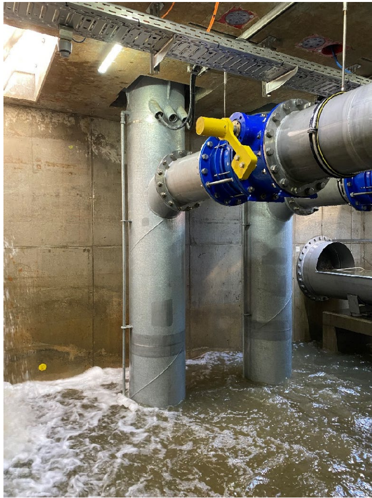
Abbildung 3: Aufnahme der Pumpenkammer während des Probetriebs (Quelle: WWA Ansbach)
