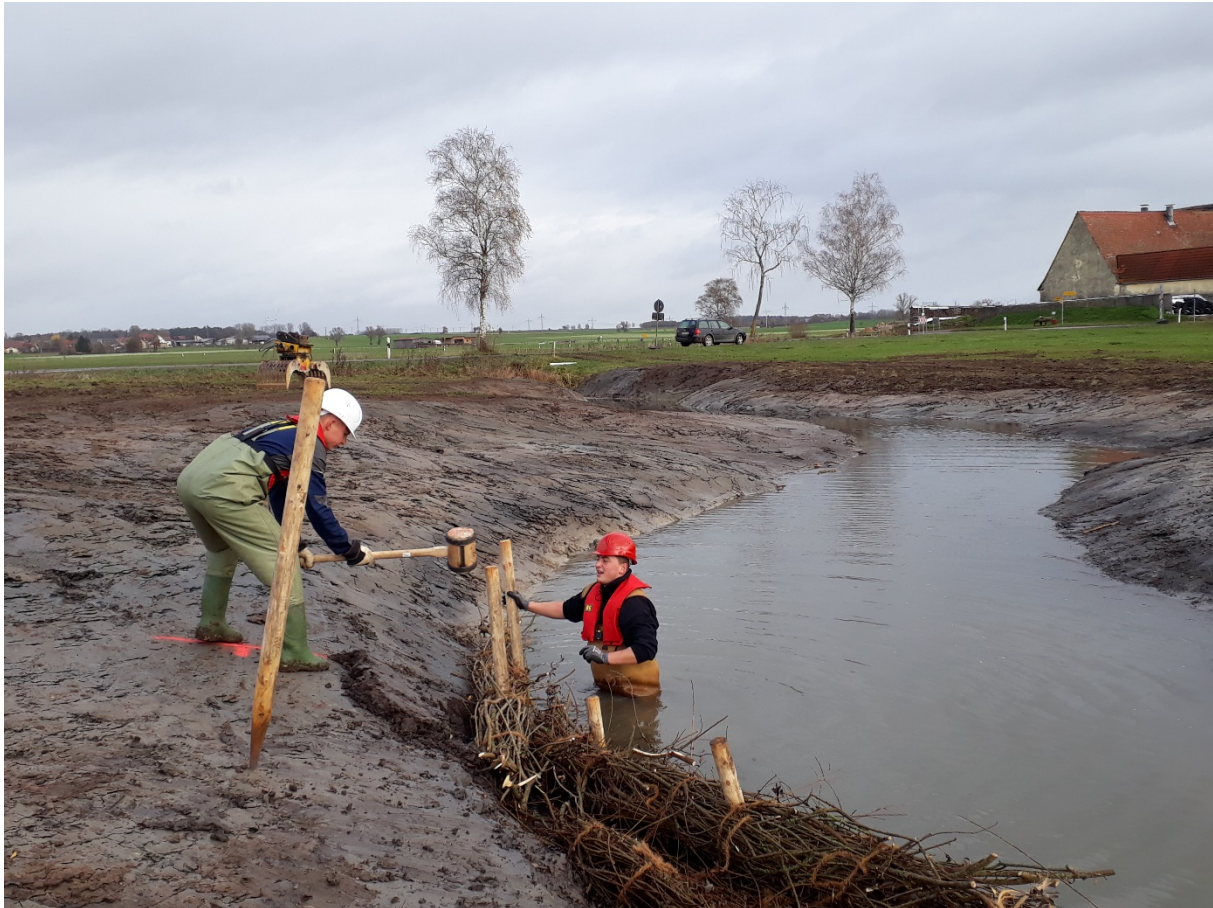
Abb.: Der Auszubildende Laurenz Jörg und der Wasserbauer Patrick Lang beim Einbau von Faschinen
