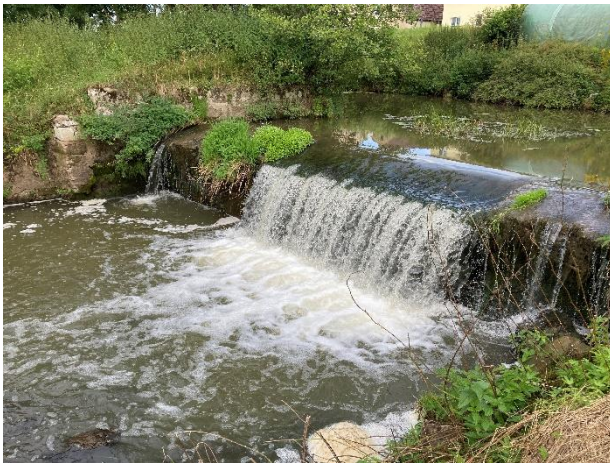
Abbildung 1: Ist-Situation 2021 im Ortsbereich von Bruck: Absturz an einem Ausleitungsbauwerk beschränkt die lineare Durchgängigkeit für zahlreiche aquatische Organismen. Bei einem Höhenunterschied von etwa 1,50 Metern wird hier die Ausbreitung selbst von leistungsstarken Fischarten verhindert. (Foto: WWA Ansbach)
